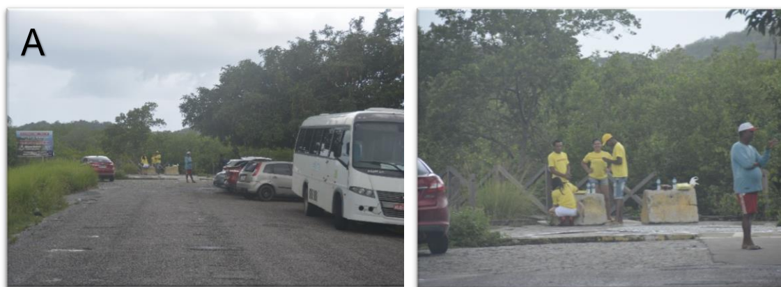
Figura 8.3.2.41 - Píer Mariassu, vendo-se as condições da estrada de acesso no trecho final e parte do guarda corpo destruído. Coordenadas: 25 L 0268655 / UTM 9039747. Fonte: Projetec, 2016 (Autor: Glívio Coelho em 22/4)
