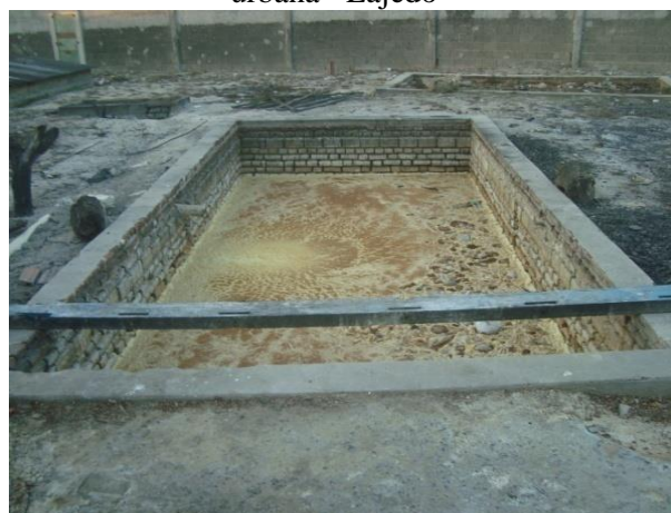
Figura 17 B - Tanque de armazenamento da manipueira em casa de farinha n°. 12 - zona urbana - Lajedo
