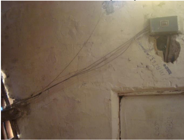
Figura 6 A - Fios elétricos expostos em casa de farinha n°.4 - Sítio Poço - Lajedo
